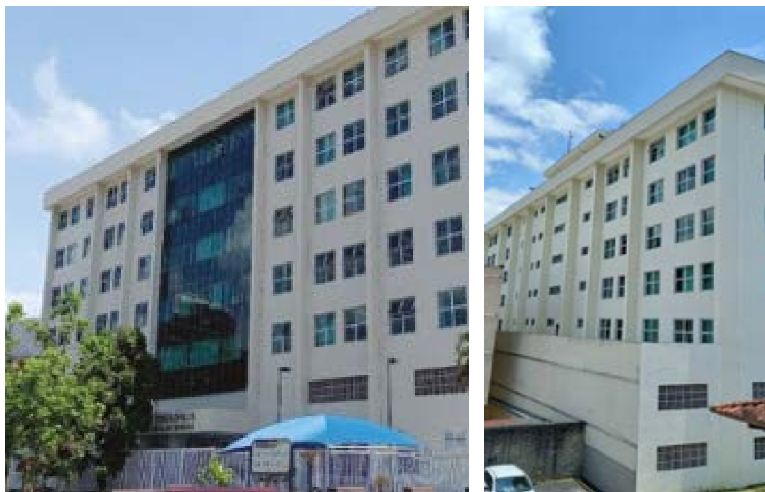
Fachada principal e lateral após a retirada dos granitos, com pintura e textura
