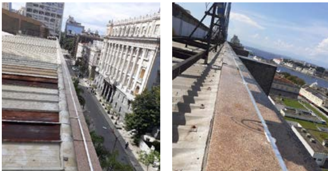
Visualização do subsistema de captação em barra chata de alumínio instalado para proteção contra descargas
