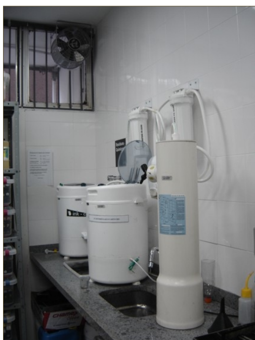
Miniestação de tratamento de água
